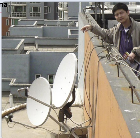
■ Algumas antenas estão montadas num gradeamento lateral: o prato de 75 cm está virado para os 134° Este e o prato de 60 cm tem um motor MOTECK.
